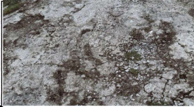
Foto 1: Patio en mal estado
