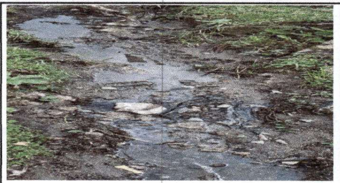
Foto 2: Cuneta en mal estado
